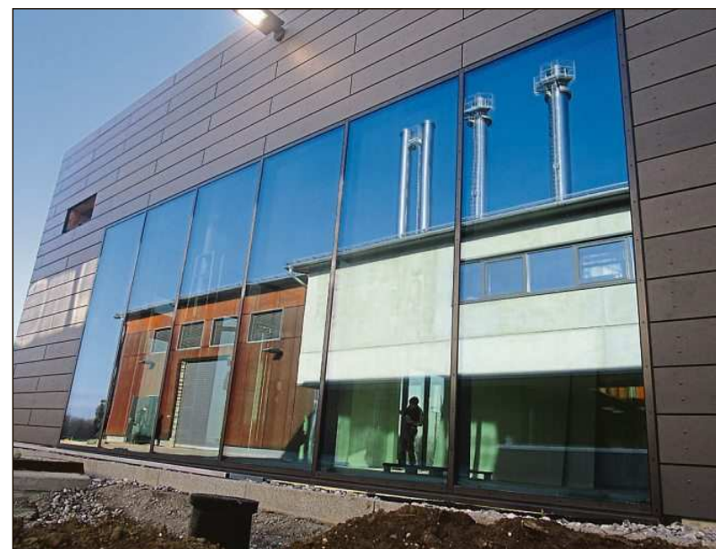
Die Glasfront der Energiezentrale.
